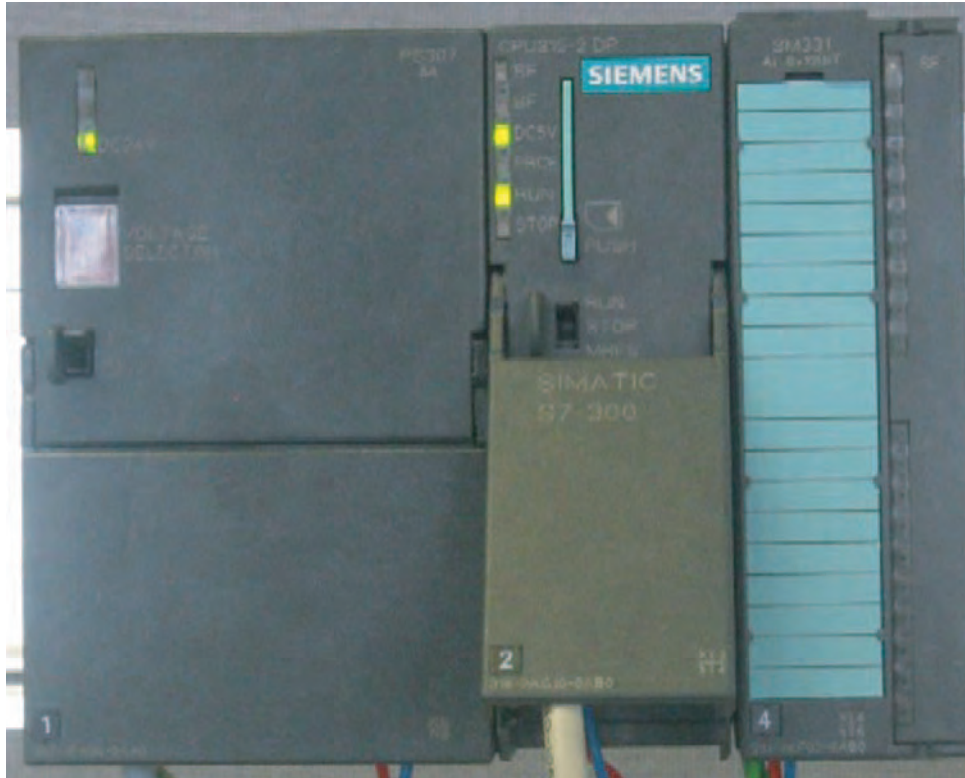
Bild 6-14 CPU im fehlerfreien Zustand
